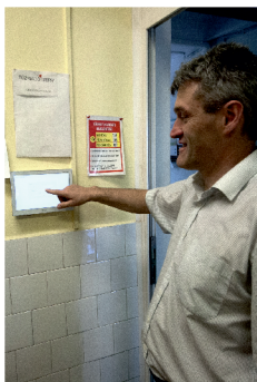
Központi hűtő-fűtő rendszer (VRV) kiépítése
