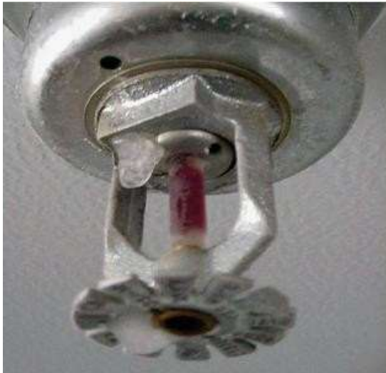
Elfagyott sprinkler szórófej
