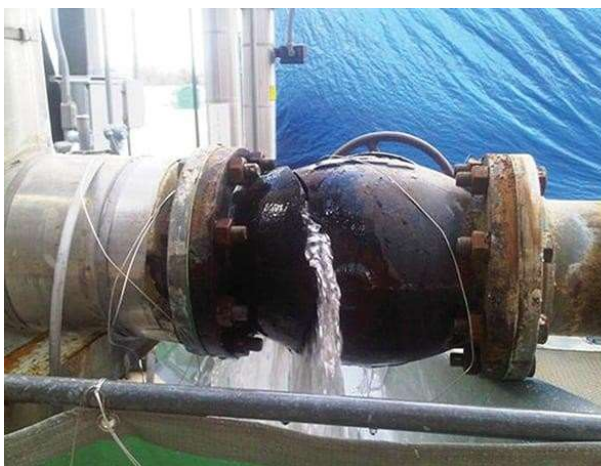
A 2011. évi texasi hidegben eltört tűzvíz vezetéki zárószerelvény
