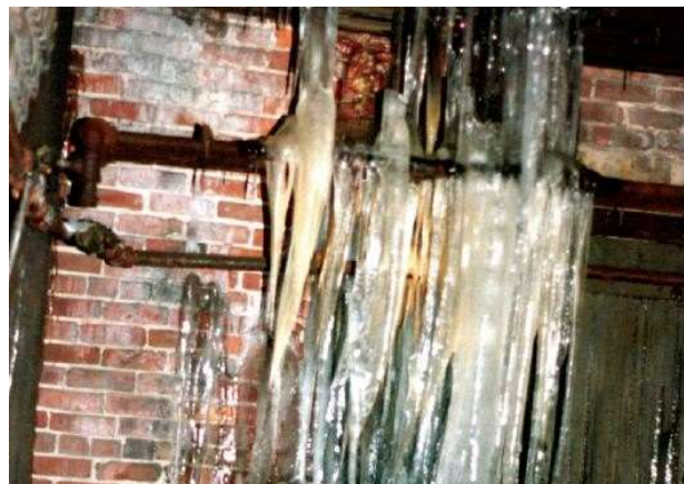
Az üres üzemi épület elégtelen fűtése kiterjedt fagykárt okozott
