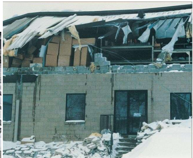
Téli viharban megrongálódott tetőszerkezet
