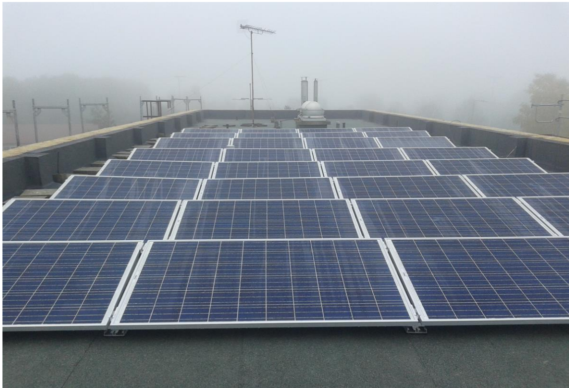
KEOP Bartók Béla úti épület napelemek felhelyezése után
