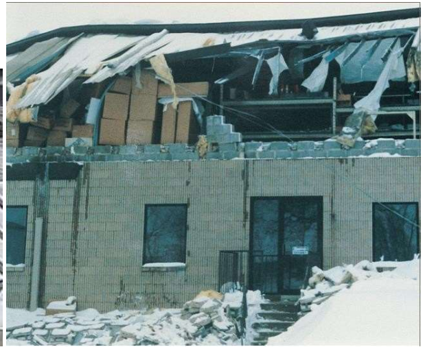
Téli viharban megrongálódott tetőszerkezet
