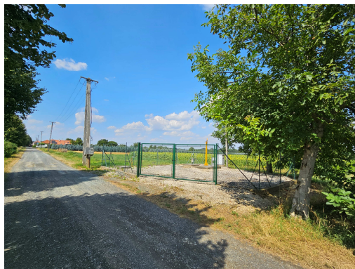
A 338/2 hrsz-ú ingatlanon lévő szennyvízátemelő fényképe
