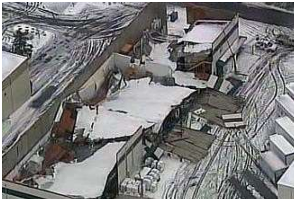
Üzemi épületek beszakadt tetőszerkezetei
