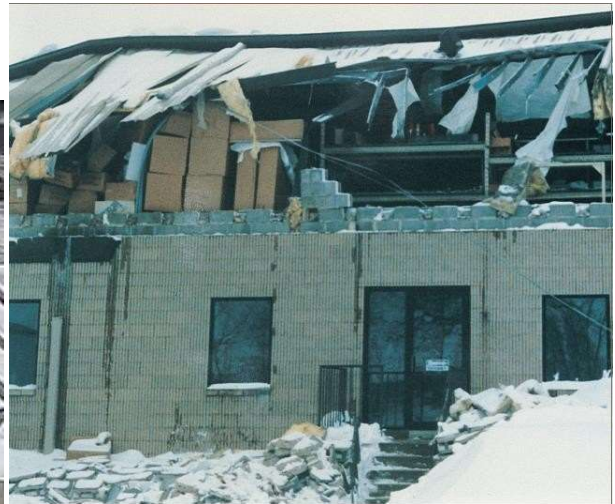
Téli viharban megrongálódott tetőszerkezet
