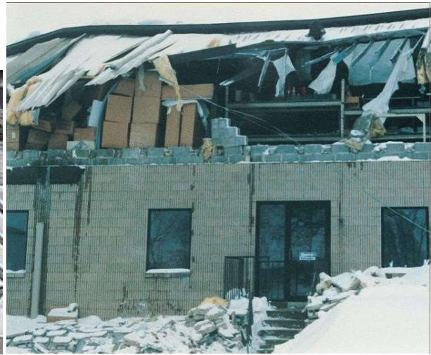
Téli viharban megrongálódott tetőszerkezet
