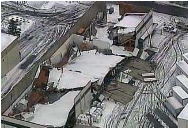
Üzemi épületek beszakadt tetőszerkezetei
