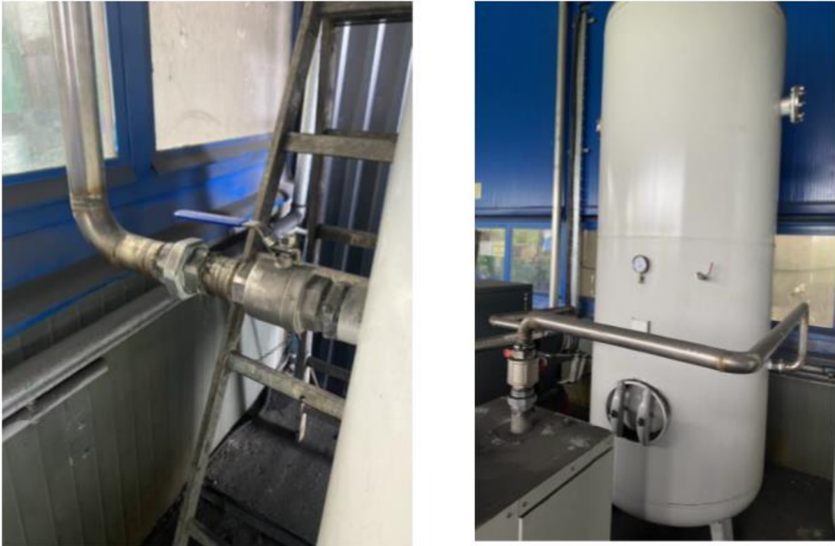
20. ábra: Nitrogéngenerátor és az ipati nitrogén csatlakoztatása
