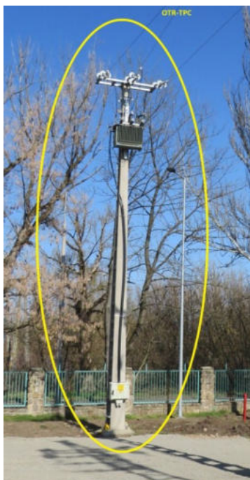
2. kép: A telepítendő OTR állomástípus fényképe.
